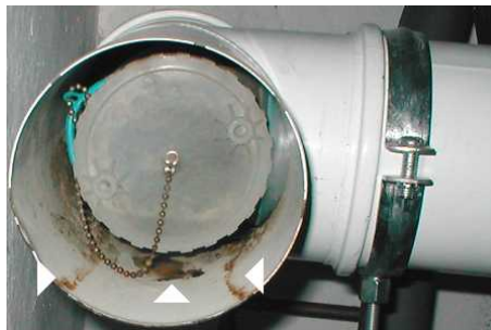
Rostschäden an einer Abgasleitung
