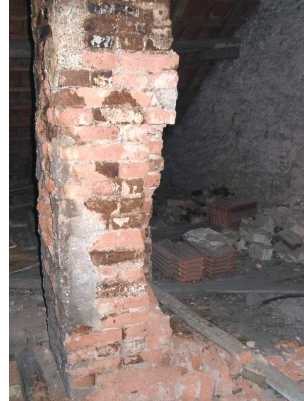
Ein vollkommen defekter Schornstein, an dem ein neuer Ofen angeschlossen wurde. Hier besteht bei der Benutzung Brandgefahr.
