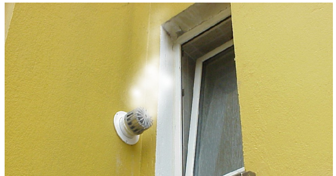
Eine neue Gasheizung wurde hier direkt mit der Abgasmündung neben einem Wohnfenster installiert. Die Abgase können so in den Wohnraum gelangen.
