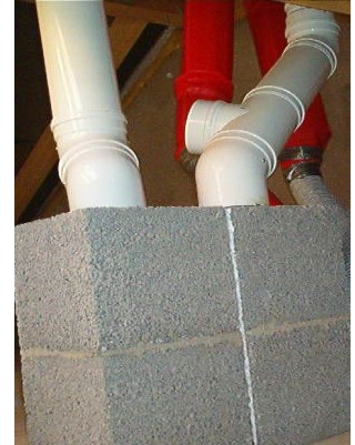
Hier endet die sichere Um-mauerung für eine Abgasleitung auf dem Dachboden. Eine Brandübertragung auf den Dachboden ist möglich.
